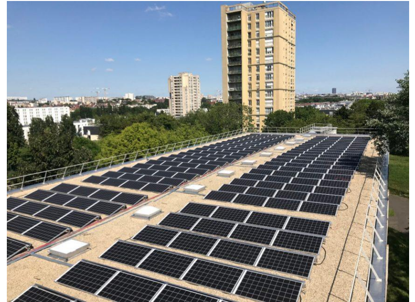
Centrale Solaire de Sud Paris Soleil sur le toit de l'école primaire de Cachan. Photo : énergie partagée
